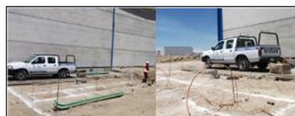
Ilustración 1: Ubicación de registros y disparo de cable de cobre desnudo de 4/0 A.W.G para aterrizamiento transformadores.
