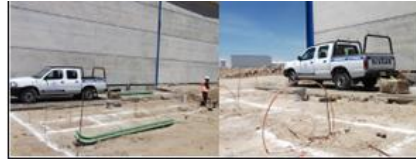
Ubicación de registros y disparo de cable de cobre desnudo de 4/0 A.W.G para aterrizar transformadores.
