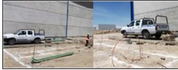
Ilustración 1: Ubicación de registros y disparo de cable de cobre desnudo de 4/0 A.W.G. para aterrizar transformadores.
